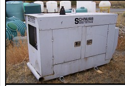
37.5 KVA 480 VOLT 3 PHASE KUBOTA DIESEL GENERATOR
