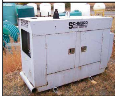
37.5 KVA 480 VOLT 3 PHASE KUBOTA DIESEL GENERATOR
